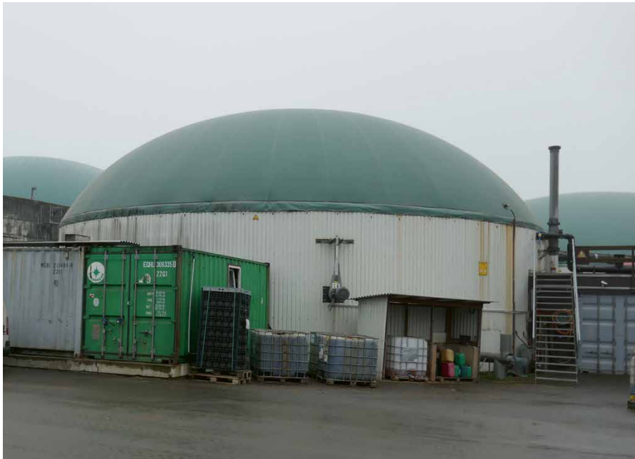
Ein Zusatz auf Basis von Kalkstickstoff kann in Güllelagern und Biogasanlagen die Methanemissionen stark senken. Foto: Fritz Fleege
