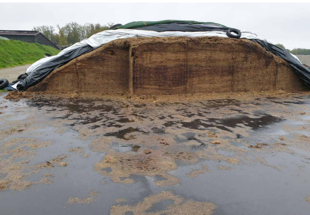
Silierplatte mit unkontrolliertem Abfluss von Sickersäften. Der Einlauf ist zudem fast verstopft. Eine unerwünschte Umweltgefährdung mit Bußgeldern droht. Fotos: Nußbaum
