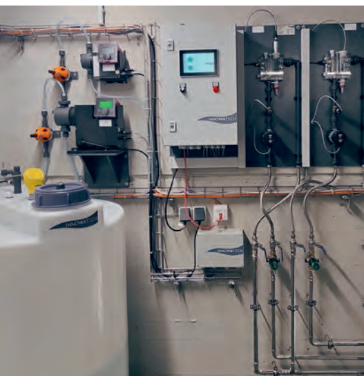
Multi-Mess-Center, Anolyte-Tank und Dosiertechnik. Werkfotos
