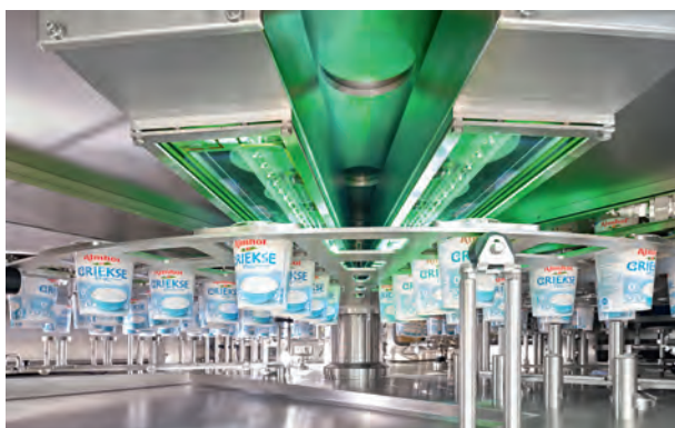
Hochleistungsstrahler des zweifach Pulsed-Light-Hochleistungs-UV(C)-Entkeimungsverfahrens im Hygienetunnel eines 4-bahnigen Becherfüllers GRUNWALD-ROTARY 20.000UC. Fotos: Grunwald
