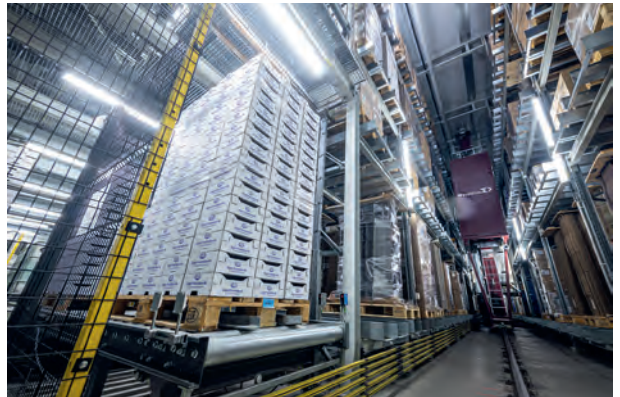
Kompakte Lagerkapazität, geringere Kühlkosten und schnelle, sichere Warenbewegungen zeichnen das automatische Lagersystem der Züger AG in Oberbüren (CH) aus. Foto: Westfalia Technologies GmbH & Co. KG / Marcello Engi
