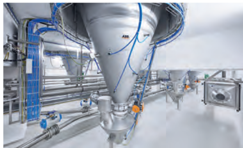
Innensilo-Auslauf mit Belüftungsdüsen und anschließender Dichtstrom-Förderung.
