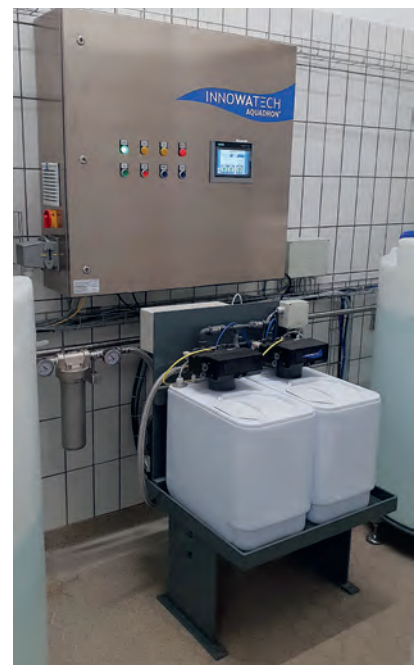
INNOWATECH Aquadron® GXL – Brudenwasser-Behandlung in der Molkerei.
