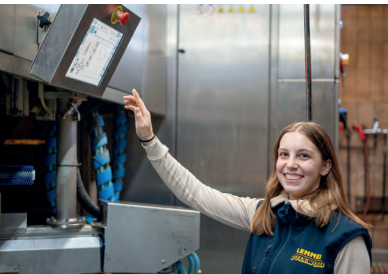
In den ursprünglichen Melkstand wurden auf beiden Seiten die M²erlin-Systeme installiert und die vorhandene Melkgrube weiter genutzt. Dadurch ergibt sich ein komfortabler Stand bei Kontroll- und Wartungsarbeiten am Melkarm.
